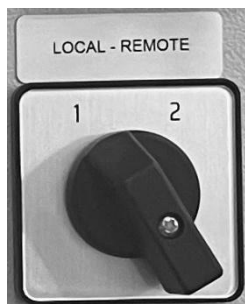
RYS. 7-6. PRZEŁĄCZNIK LOKALNIE - ZDALNIE
